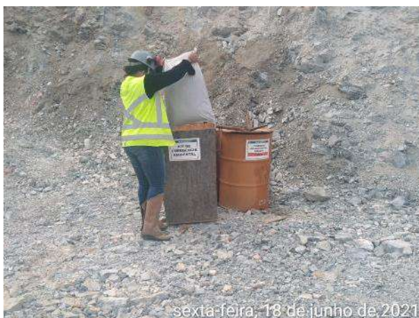
Foto 125 – Abastecimento do Kit de emergência ambiental 01 disponível na frente de serviço da injeção. (Data:18/06/2021)
