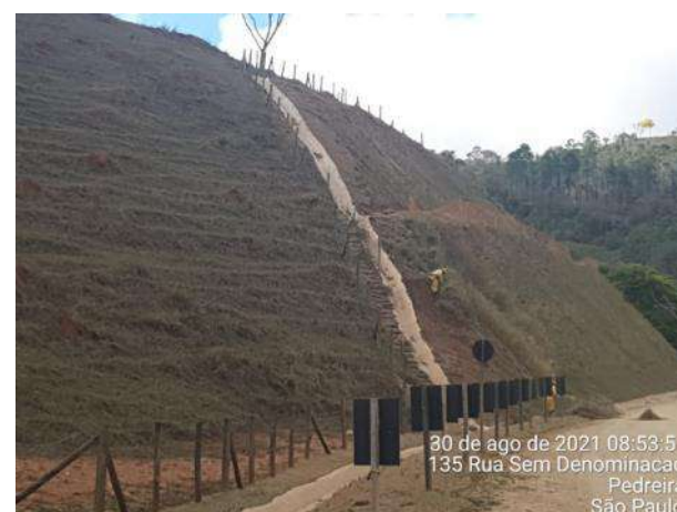
Foto 367 – Inspeção em talude e em drenagem da MD03 pós-chuva. (Data:30/08/2021)
