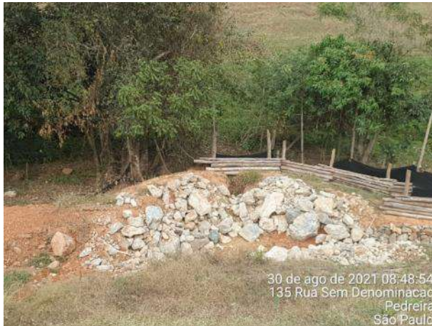
Foto 368 – Inspeção em contenção ambiental - MD03. (Data:30/08/2021)
