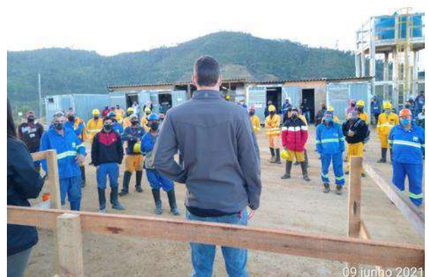
Foto 70 – Palestra sobre os materiais que compõem o barramento do empreendimento – 1º turno. (Data:09/06/2021)
