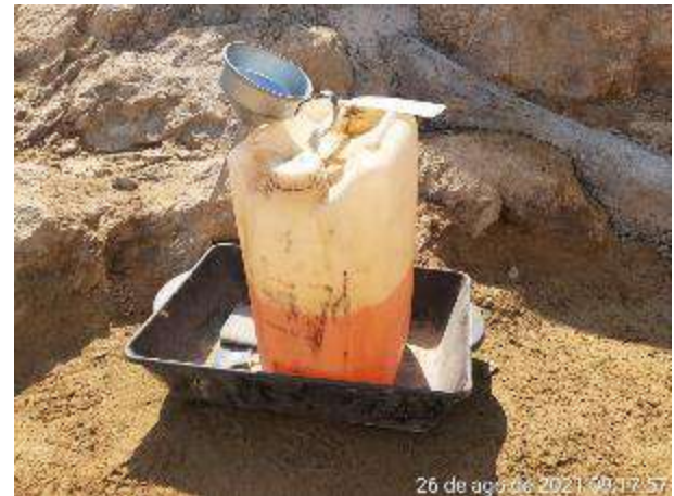
Foto 136 – Produtos químicos dispostos na frente de serviço com a bacia de contenção e identificação. (Data:26/08/2021)
