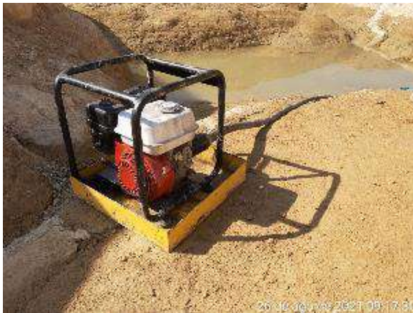
Foto 135 – Bomba dispostas na frente de serviço com a bacia de contenção. (Data:26/08/2021)
