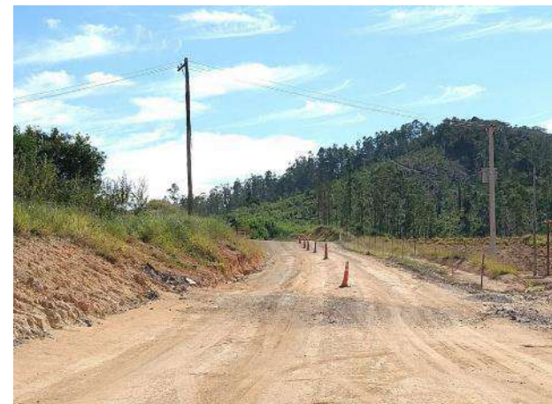
Foto 303 – Sinalização de de cones no canteiro operacional. (Data:28/05/2021)
