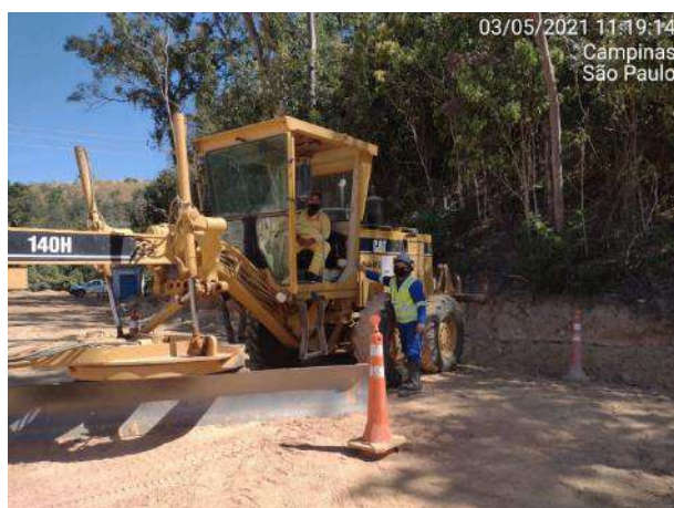
Foto 216 – Inspeção em equipamento Motoniveladora. (Data:03/05/2021)
