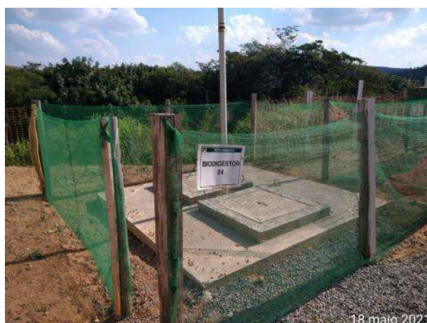
Foto 402- Biodigestor 04 no canteiro administrativo. (Data:18/05/2021)
