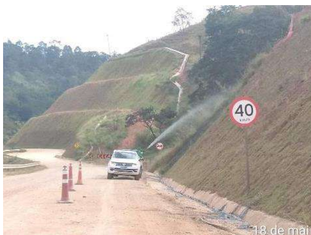
Foto 284 – Sinalização de limite máximo de velocidade no acesso da MD03 - estrada municipal de Pedreira. Data:18/05/2021)
