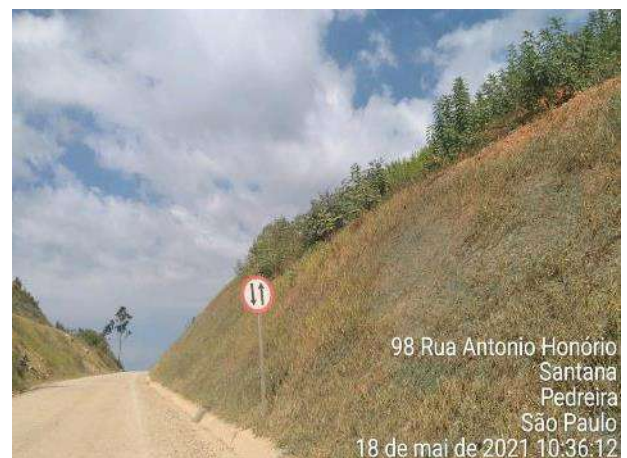
Foto 283 – Sinalização via externa – acesso MD03. (Data:18/05/2021)
