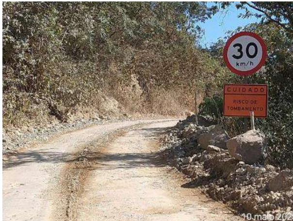
Foto 300 – Sinalização de velocidade máxima permitida na via e risco de tombamento – acesso margem direita. (Data:10/05/2021)
