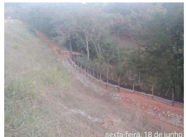
Foto 355 – Inspeção em contenção ambiental na MD03. (Data:18/06/2021)
