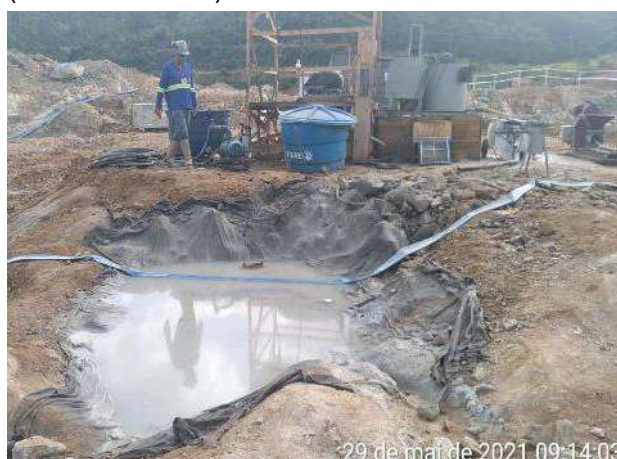
Foto 378 – Área para lavagem de betoneira – atividade de injeção de calda de cimento. (Data:29/05/2021)
