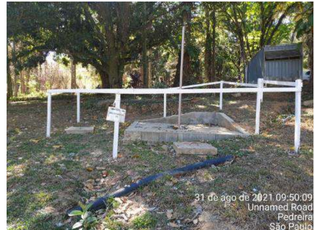
Foto 405 – Biodigestor 02 no canteiro administrativo. (Data:31/08/2021)
