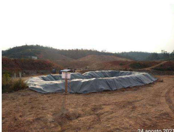
Foto 386 – Área delimitada para lavagem de calha de betoneira. (Data:24/08/2021)
