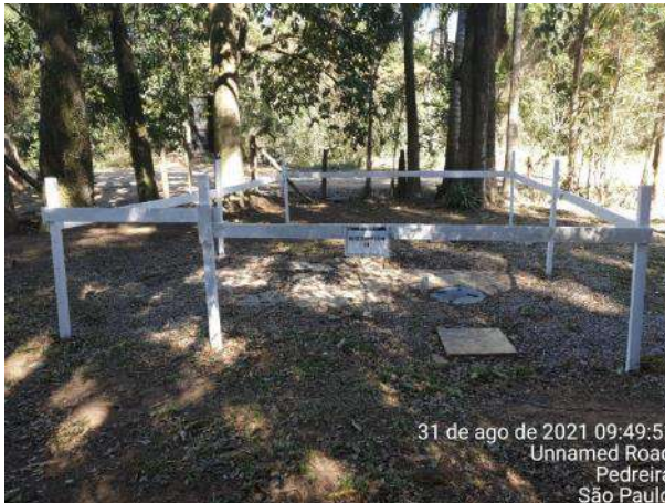
Foto 404 – Biodigestor 01 no canteiro administrativo. (Data:31/08/2021)
