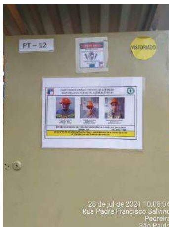
Foto 224 – Quadro de energia vistoriado. (Data:28/07/2021)
