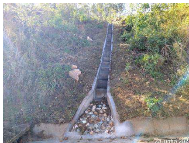
Foto 331 – Escada hidráulica no acesso - MD03. (Data:23/06/2021)
