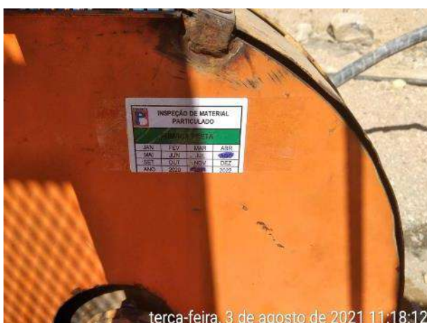
Foto 431 – Gerador com a etiqueta de fumaça preta realizada. (Data:03/08/2021)
