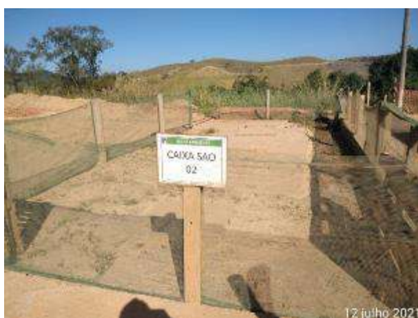
Foto 384 – Caixa SÃO 2 da área da oficina. (Data:12/07/2021)
