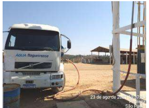
Foto 197 – Abastecimento de água potável no canteiro operacional. (Data:23/08/2021)
